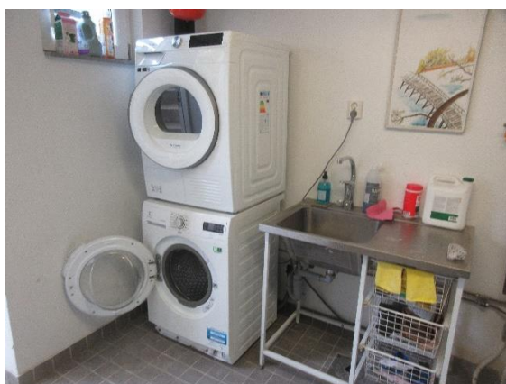
Tvättstuga i undercentralen
