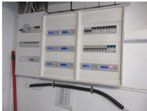
El-central med undermätare för lägenheterna.
