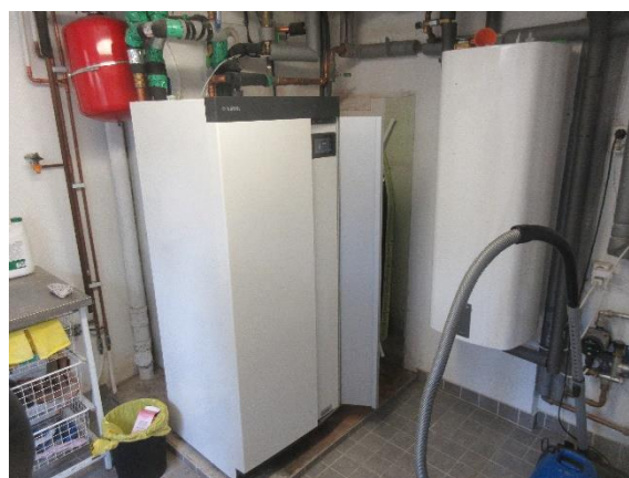
Undercentral med bergvärme
