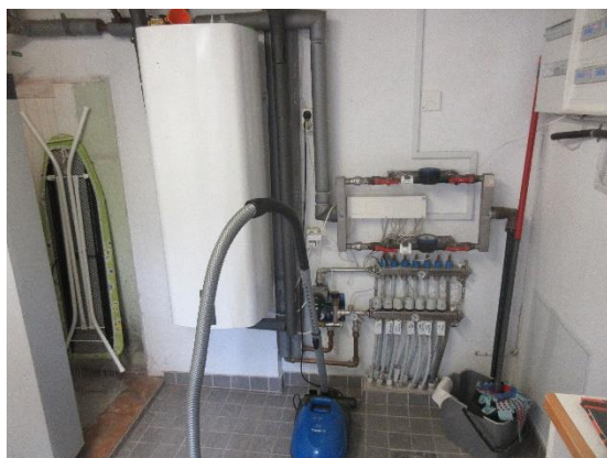
Golvvärme i källarplan
