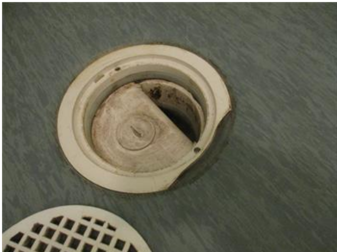
Trasig golvbrunn i wc/dusch 4 entréplan
