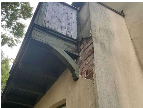
Bild 9: - Utvändigt, Övrigt, Slitet tätskikt Tätning saknas mot tröskeln Tröskeln är rötskadad Rötskadad balk under balkongen ...
