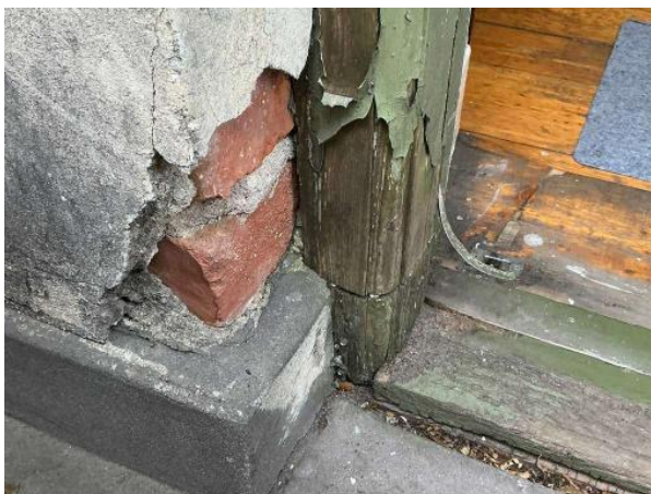
Bild 8: - Utvändigt, Övrigt, Slitet tätskikt Tätning saknas mot tröskel Rötskadad tröskel noterades Underbyggd balkong
