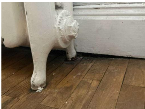
Bild 13: Invändigt, Överväning, Ojämna golv noterades
