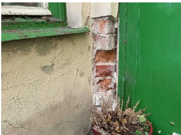
Bild 1: - Utvändigt, Fasad, Putssläpp och trasiga stenar noterades Se riskanalys
