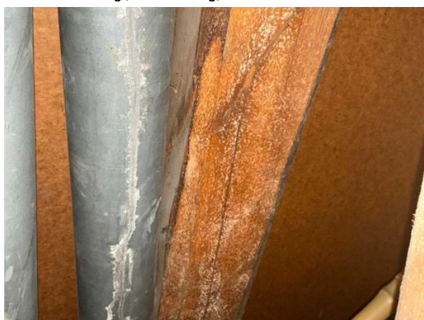
Bild 17: - Invändigt, Vindsvåning, Mikrobiell påväxt noterades Se riskanalys vind
