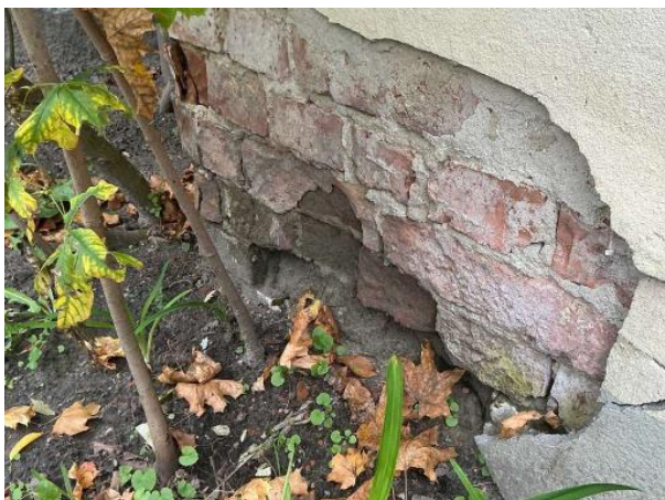
Bild 3: - Utvändigt, Fasad, Putssläpp och trasiga stenar noterades Se riskanalys
