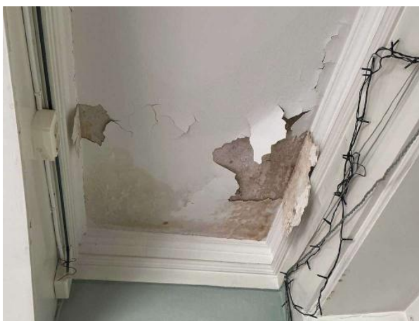
Bild 12: - Invändigt, Entréplan, Fuktfläck i taket Se fortsatt teknisk utredning (balkong)
