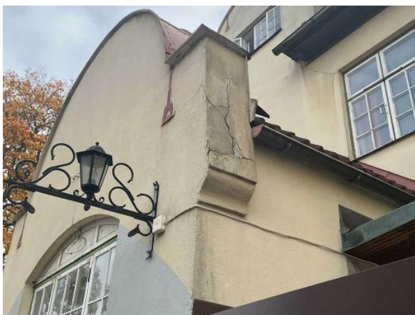
Bild 2: - Utvändigt, Fasad, Putssläpp och trasiga stenar noterades Se riskanalys
