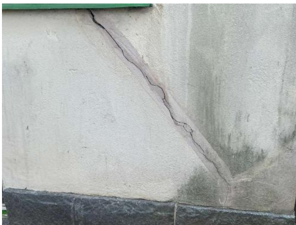
Bild 4: - Utvändigt, Fasad, Putssläpp och trasiga stenar noterades Se riskanalys
