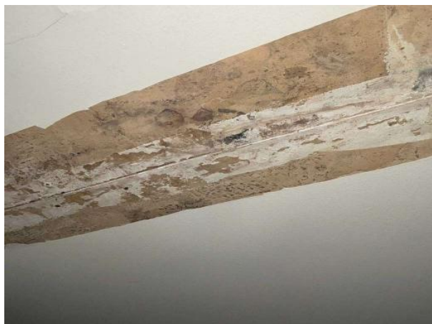
Bild 15: Invändigt, Vindsvåning, Fuktfläck i taket
