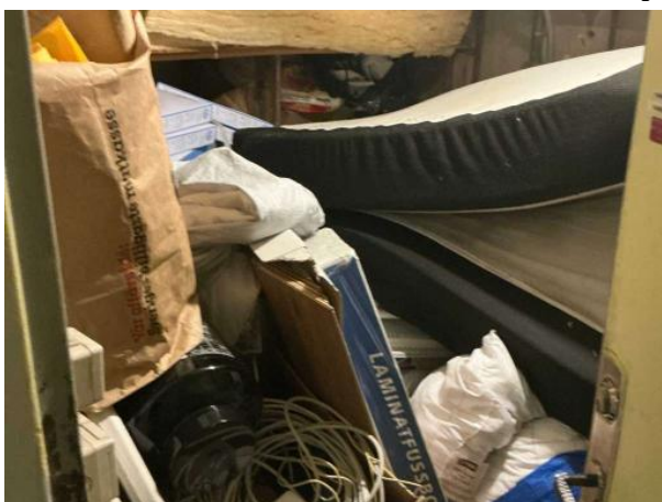
Bild 11: - Invändigt, Källarplan, Äldre våtrum Avvikande lukt Belamrat med bohag (utgår ur besiktningen) Se riskanalys samt fortsat...
