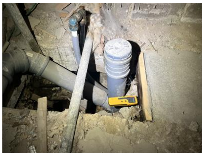
Förhöjda fuktvärden i träregel i utrymme med inkommande vatten. Åtgärder bör utföras.
