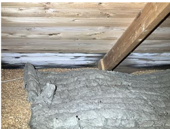
Mikrobiell påväxt i underlagstak mot takfoten.
