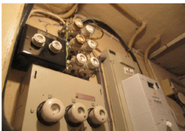
Brister i elektriska installationer
