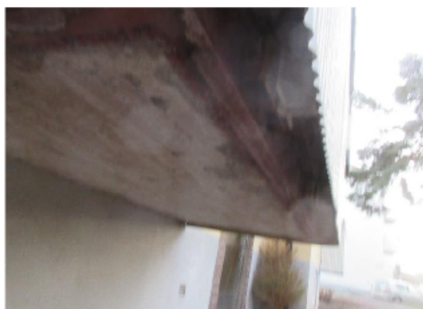
Kantbalkar på balkongerna har begynnande ytrost
