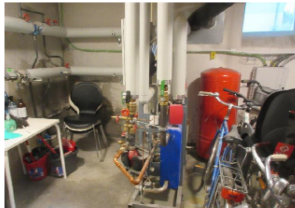
Undercentral för värme och varmvatten
