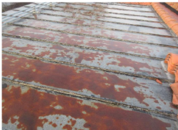
Rostigt plåttak på takkupan
