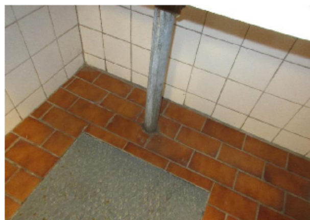
Galvaniserat vattenrör in i byggnaden
