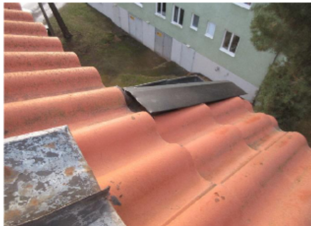
Felaktiga plåtanslutningar vattplåt
