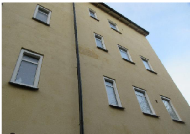
Missfärgning på fasaden, tyder på fukt
