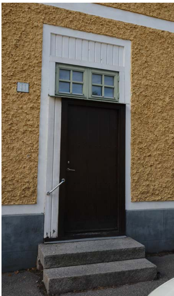
Bild 17. Entrédörren mot gatan är utbytt till en dörr som inte passar husets ursprungliga karaktär (SLM D2017-0022).
