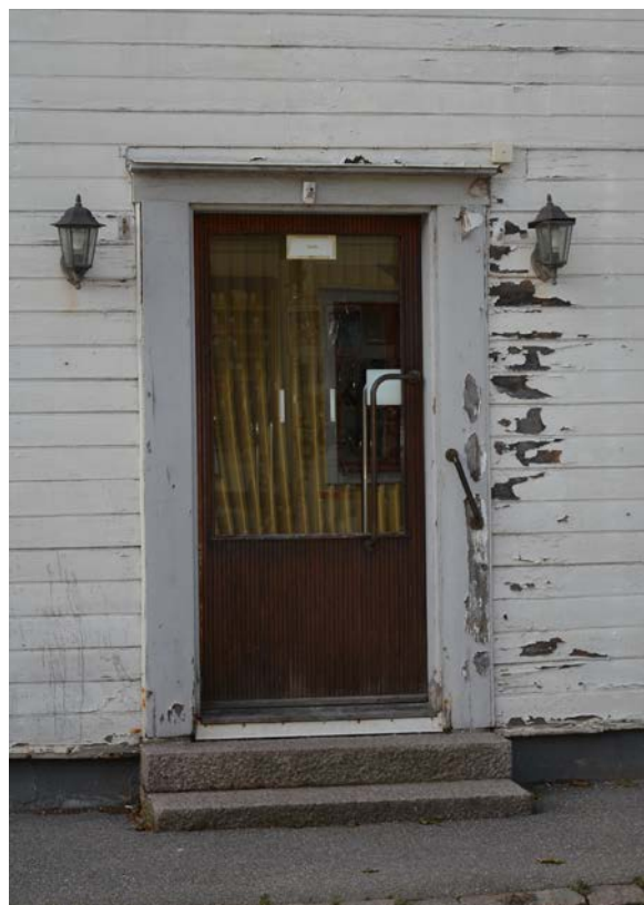
Bild 18. Fasaden är målad med fel typ av färg som flagnar i stora sjok (SLM D2017-0024).
