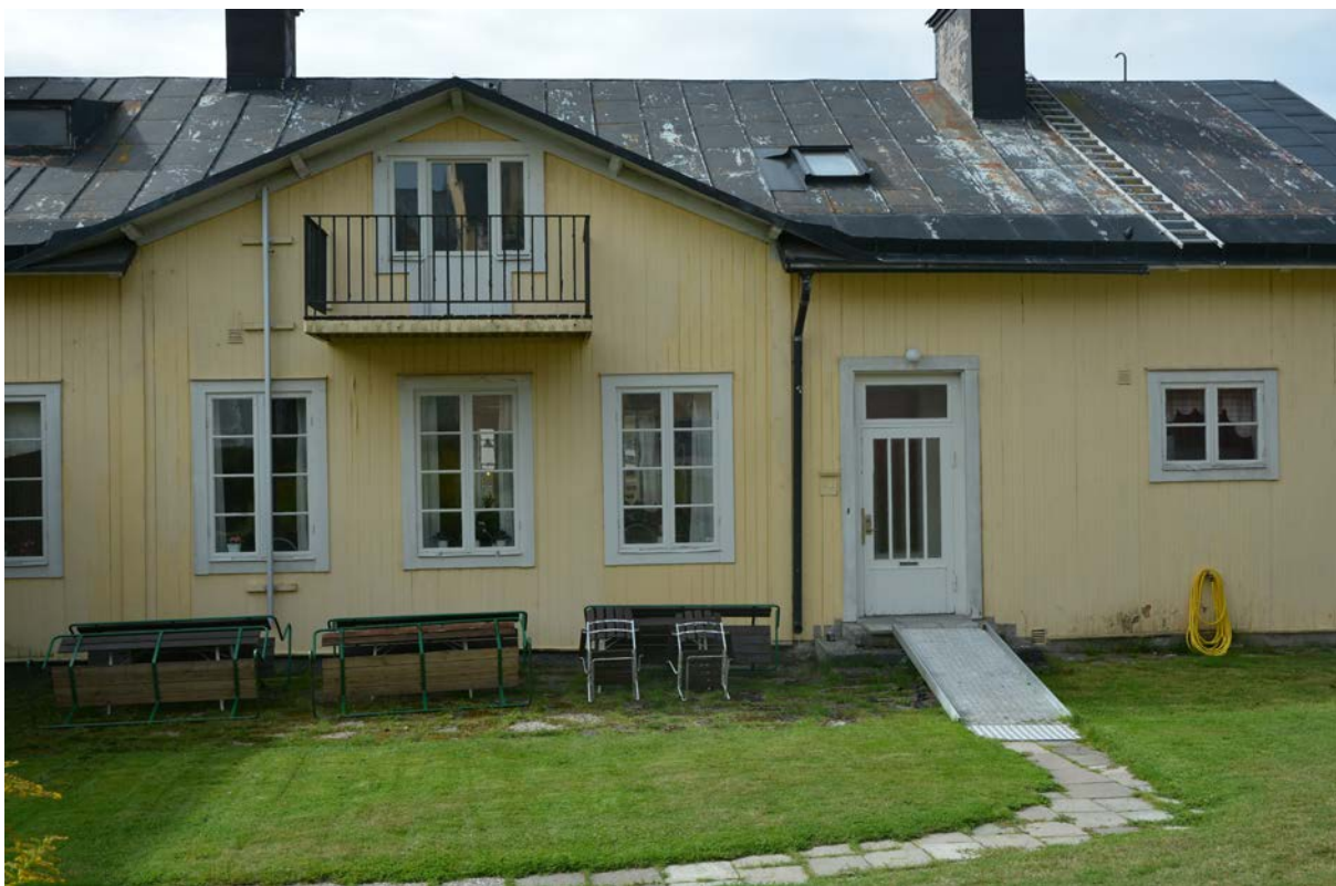
Bild 21. Möjligen kunde rampen ha tillverkats i sten. Fasaden är målad i plastfärg som flagnar (SLM D2017-0026).
