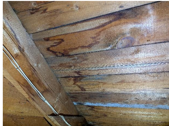
Fukt- och rinnmärken på underlagstaket.
