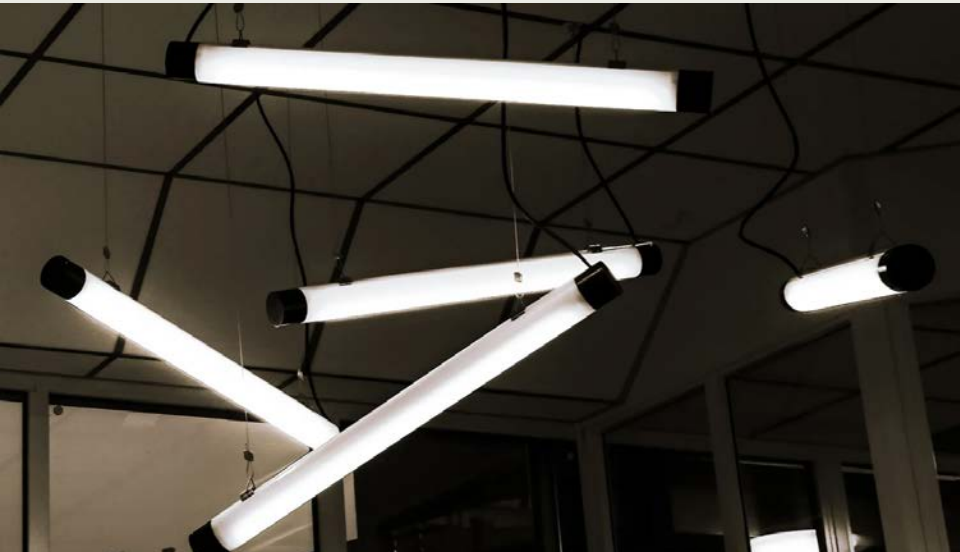
Synligt betongbjälklag med installationer och pendlade armaturer,
