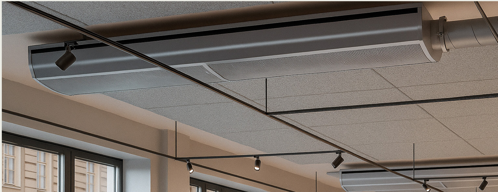
Taklösning: Synliga inmålade installationer och diktlimmade akustikplattor. Flexibelt belysningsystem med möjlighet för Hyresgäst att lätt hänga om belysning efter möblering.
