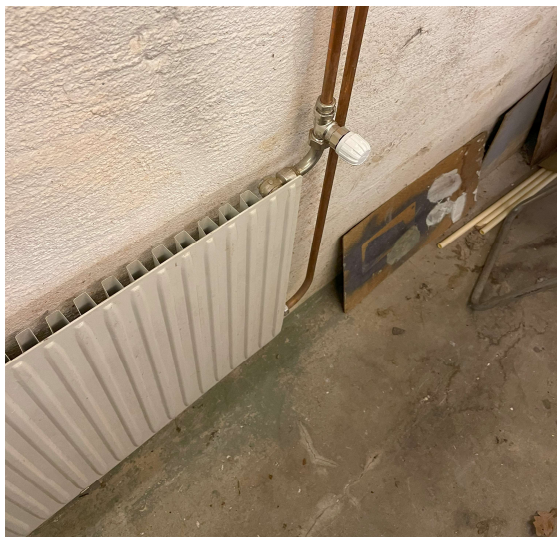
Befintlig ventil för radiator i byggnaden, med avsaknad termostatfunktion
