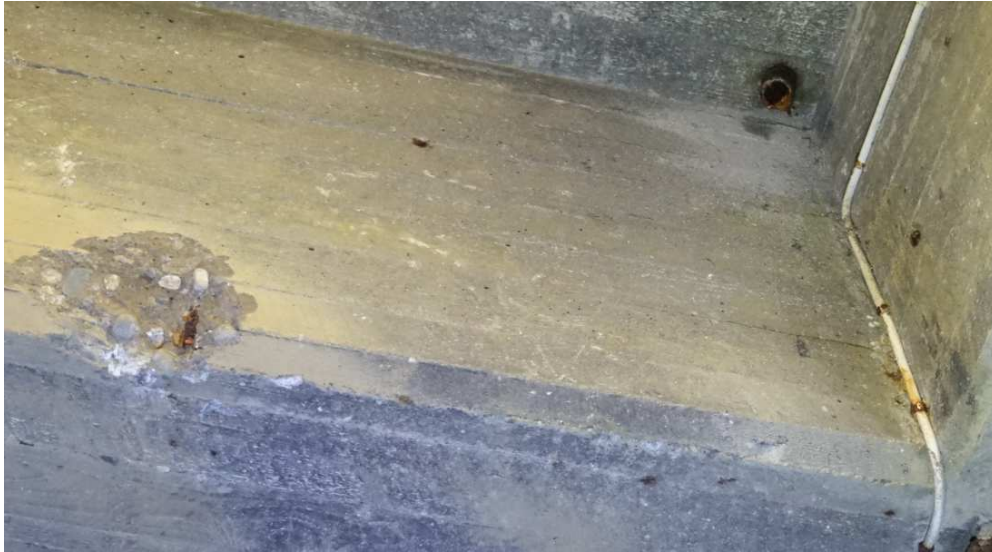
Figur 7 Mindre skada på betong vid schakt.
