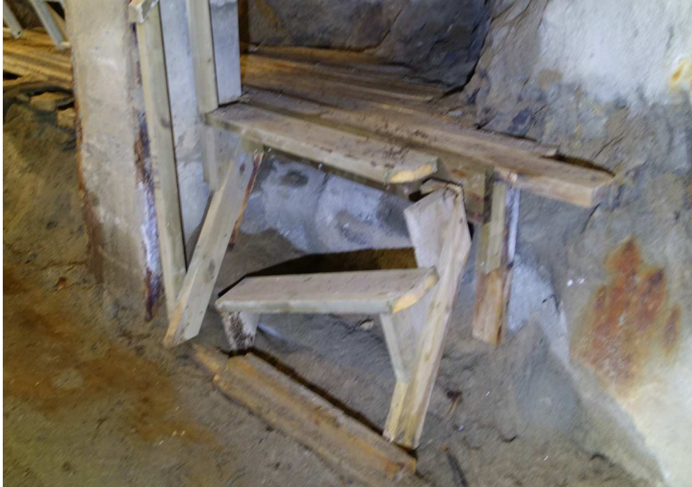
Figur 15 Trasig trappa vid schakt.
