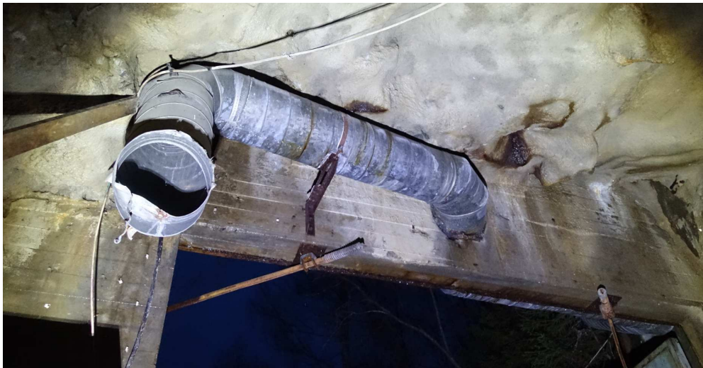
Figur 14 Foto på saknad ventilation vid port.
