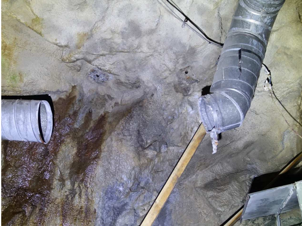
Figur 13 Foto på saknad ventilation vid port.
