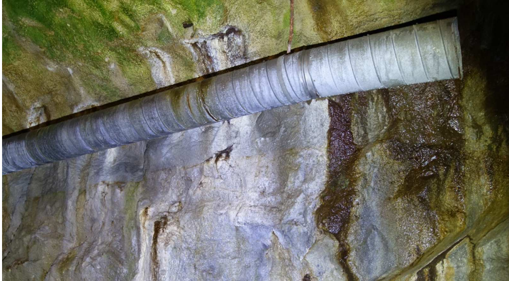
Figur 2 Område med algpåväxt på sprutbetong.
