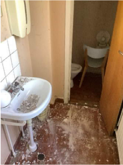
Bild 4.21: Handfatet under det fuktskadade undertaket
