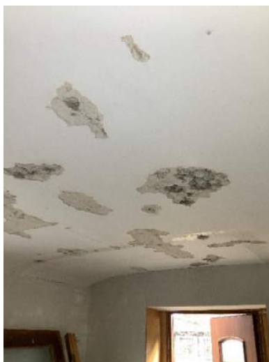
Bild 4.14: Betongskador i taket i den östra delen
