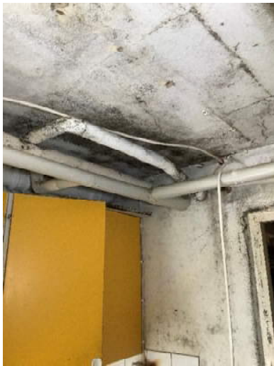
Bild 4.12: Påväxt med svartmögel i tak i källare under vattenskada
