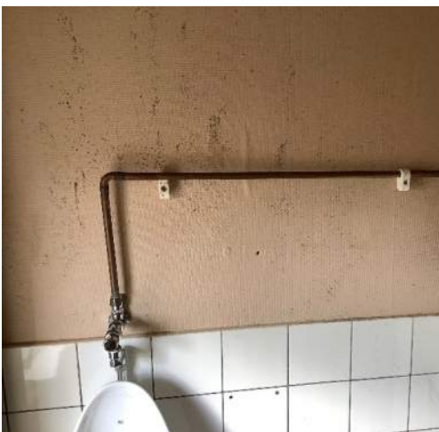
Bild 4.18: Den lossade ledningen ovan urinoaren
