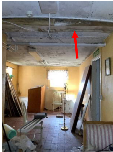
Bild 4.13: Påväxt med svartmögel i tak, inbyggd träbalk med fuktskada vid pilen
