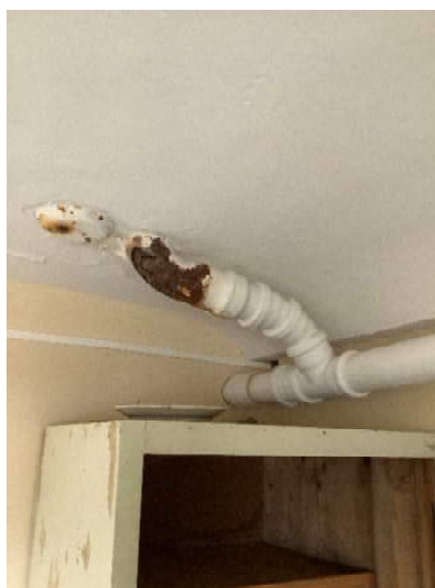
Bild 4.15: Skadat avloppsrör i källaren (i övrigt har inga skadade avloppsrör kunnat observerats)
