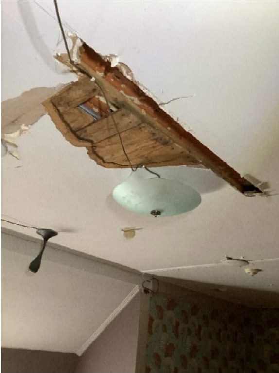
Bild 4.26: Skada i undertak vindspan, ej bedömt som fuktskada utan snarare från rivning
