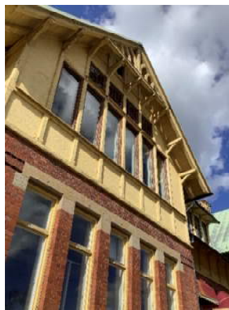
Bild 4.6: Fasad mot söder, notera vägglucka till vind som står öppen
