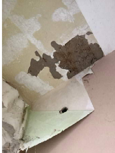
Bild 4.22: Fuktskadat undertak ovan handfatet
