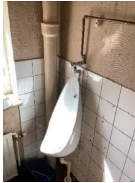
Bild 4.17: Urinoar där med lossad ledning
