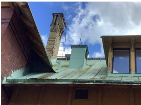
Bild 4.1: Exempel på skicket på plåttaket, här fasad mot norr
