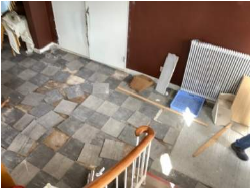
Bild 4.16: Skador på betonggolvet pga vattenskada
