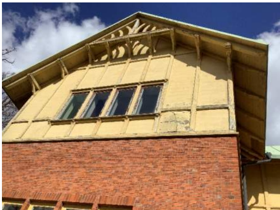
Bild 4.3: Fasad mot väster med skada i fasad på plan 2
