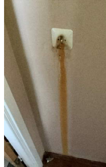
Bild 4.23: Vatten har trängt ut ur väggen vid elledning
