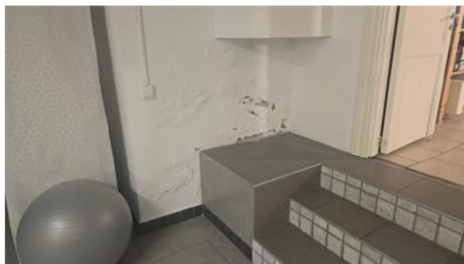
Exempelbild, puts/färgsläpp källarvägg.
