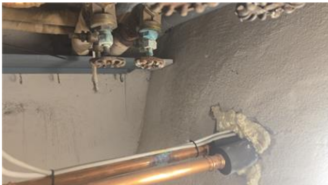
Exempelbild, rost/ärgangrepp på äldre rör/kopplingar, pannrum.
