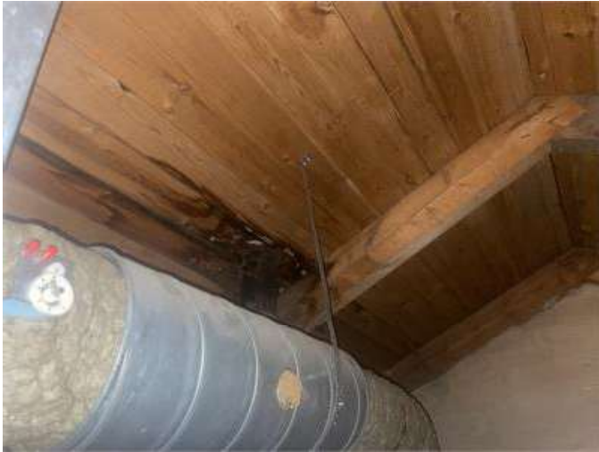
Vind med gamla fuktgenomslag
