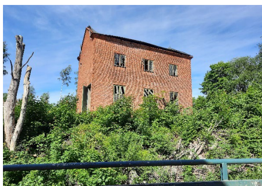
Bild 9: Transformatorhuset i slänten ner mot Svenbybäcken.
